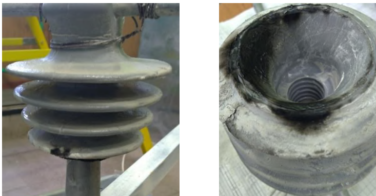
Рис. 2. Следы на нижней части изолятора ШПН№1 при проведении испытания в увлажненном и загрязненном состоянии
