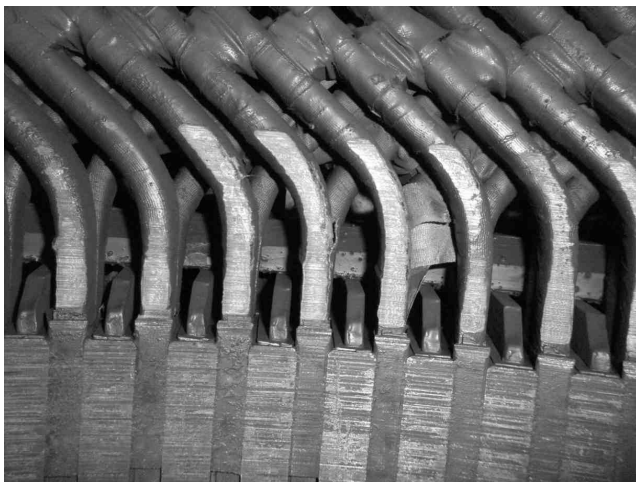
Рис. 1. Фотография поврежденной обмотки статора
