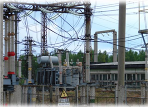
ПС 330 кВ «Лоухи»
