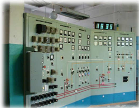
Подстанция Лоухи старого поколения
