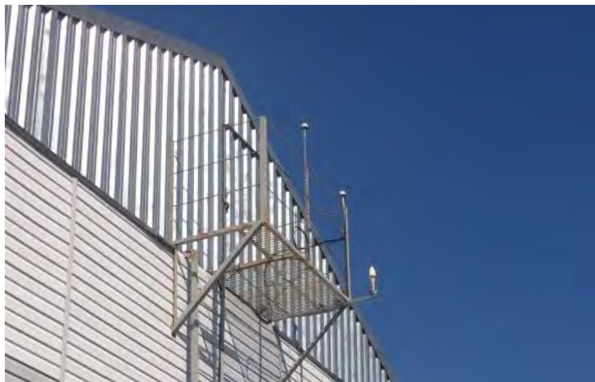
Рис. 3.21. Антенны GPS, установленные с южной стороны релейного щита ПС Тамбовская 500
