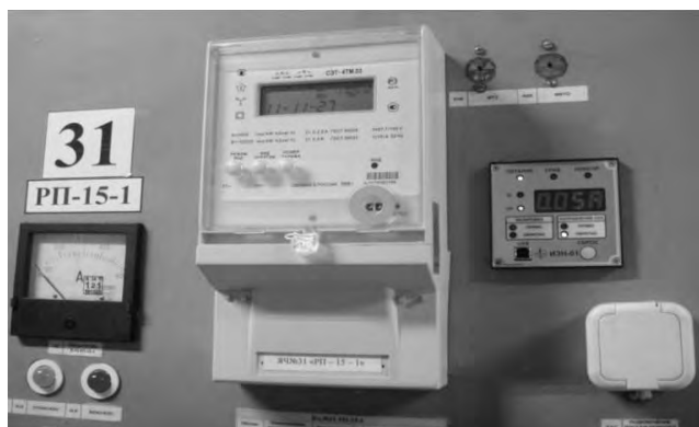
Рис. 4.11. Установленное устройство ИЗН
